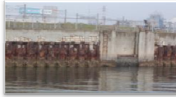
(鋼矢板の腐食・コンクリートの劣化)
