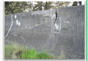
(堤防のひび割れ)
