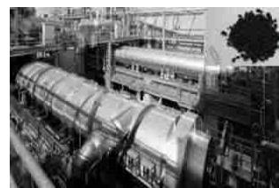
下水汚泥の固形燃料化 （広島市）
