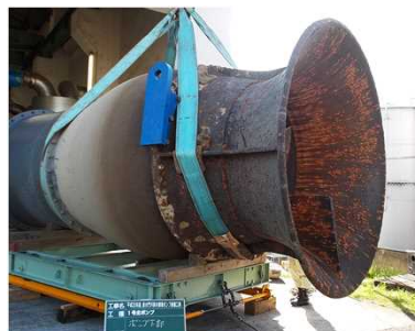
写真 新水門川排水機場の1号主ポンプ発錆状況
