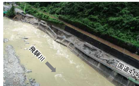
国道41号 道路崩壊 橋梁流失 (岐阜県下呂市)
