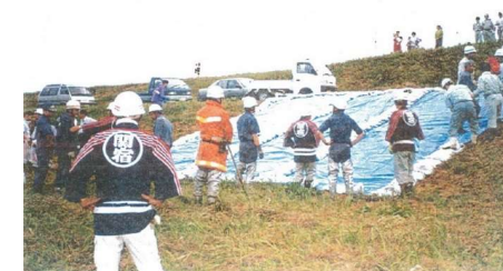
平成10年 台風5号 (江戸川左岸(現:野田市関宿元町)での堤防漏水)
