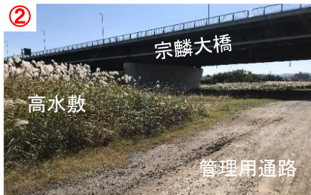
高水敷は土砂堆積や不陸があり 雑草が生えやすく、安全な利用が難しい
