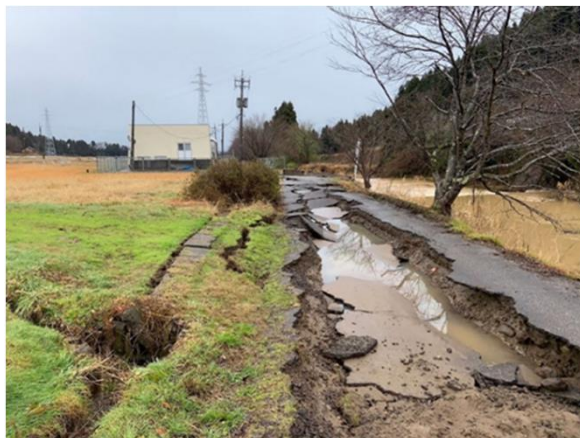
水源から浄水場に送る導水管の被災（珠洲市宝立浄水場の導水管）
