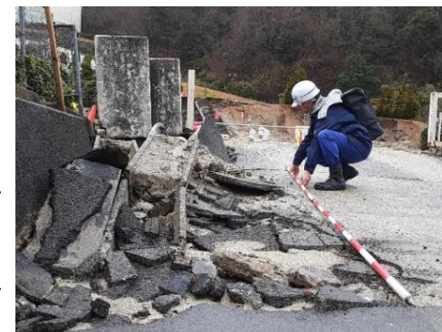
岩屋浄水場の被災（七尾市）
