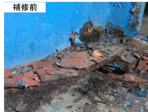
老朽化の進行による鋼部材の腐食
