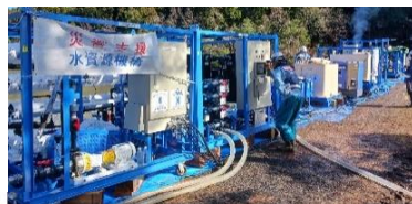
▲可搬式浄水施設による速やかな浄水機能の確保
