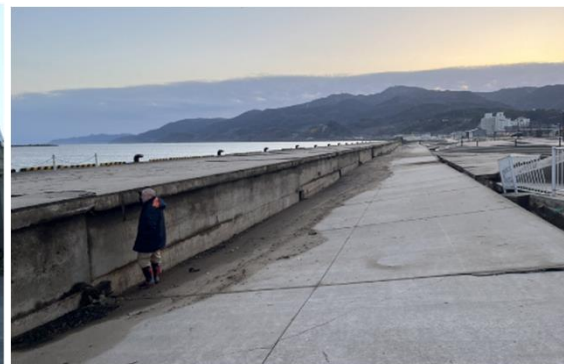
輪島港の被災（輪島市）
