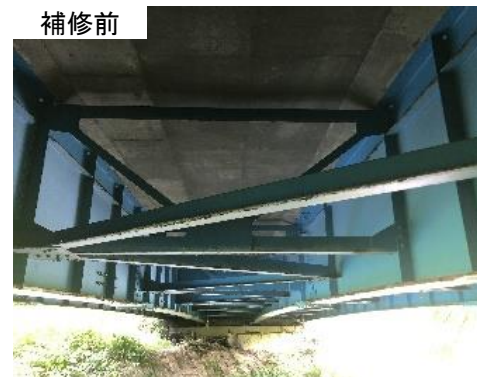
錆の発生と鋼部材の経年劣化
