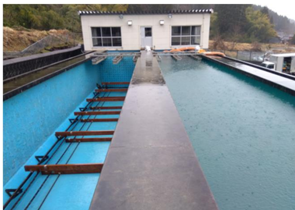
浄水場の被災（未耐震で被害のあった左池、耐震化済で機能が確保された右池）（珠洲市宝立浄水場の沈澱池）
