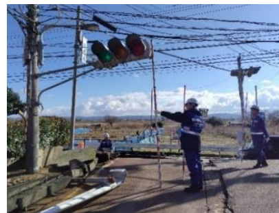
道路の被災状況調査 (石川県内灘町)
