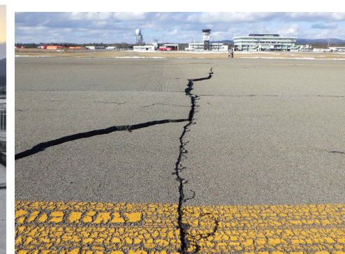
能登空港の被災（穴水町）
