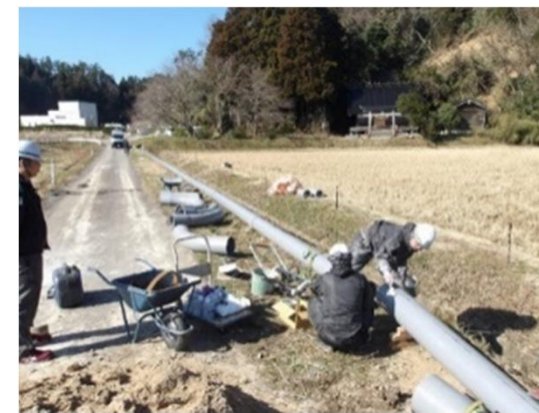
区域の下水を集約し処理場に送る圧送管の被災現場（珠洲市熊谷ポンプ場からの圧送管）
