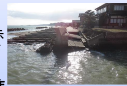
海岸堤防の護岸損壊 (宝立正院海岸)
