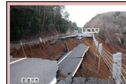
写真⑤ 能越自動車道の道路崩壊
