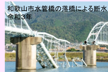
和歌山市水管橋の落橋による断水 令和3年 紀の川以北への 唯一の送水ルート の事故により、約6万世帯(市内全体の約4割にあたる約13.8万人)で断水
