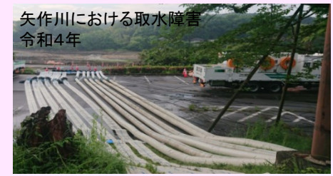
矢作川における取水障害 令和4年 上水、工水、農水を取水する施設で漏水による水供給障害が発生(農業用水は発生後76日後に全ブロック通水、工業用水は104日後に通常受水)
