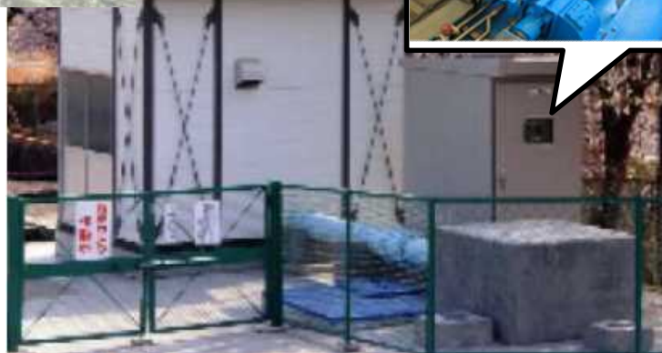
発電所設置後の現況 ▶
