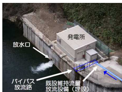
▲ 発電所設置後の現況
