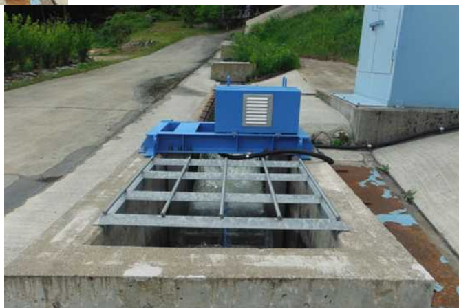
発電所設置後の現況 ▶
