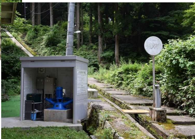
発電所設置後の現況 ▶
