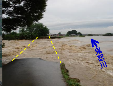
被災状況(拡大写真)
