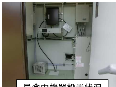
局舎内機器設置状況
