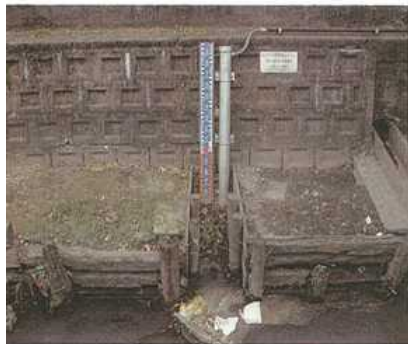
水位計設置状況
