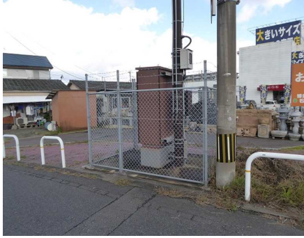
観測装置設置状況
