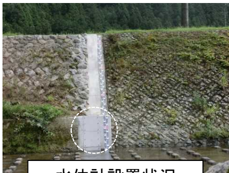
水位計設置状況
