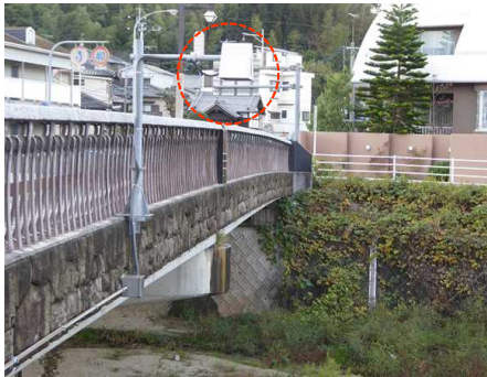
水位計設置状況
