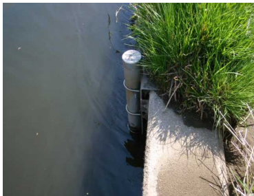
水位計設置状況(主)
