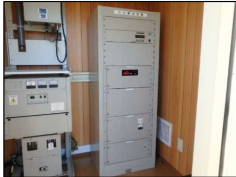
局舎内機器設置状況
