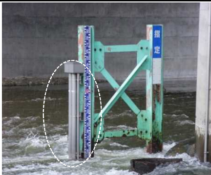
水位計設置状況
