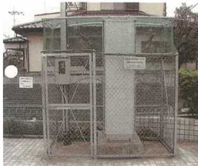
観測装置設置状況
