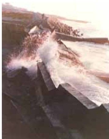
直立堤の被災状況 (黒部市荒俣地先)
