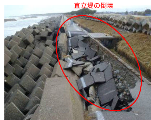
直立堤の倒壊
