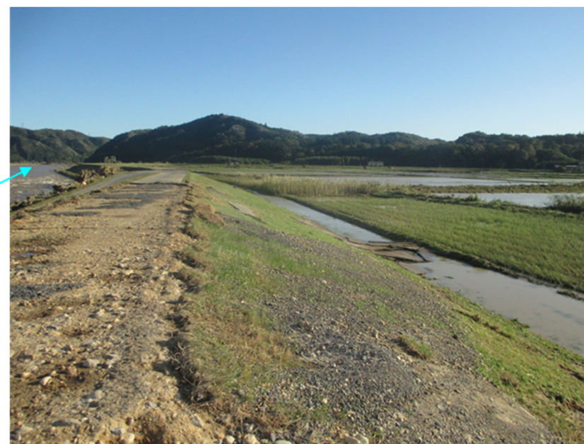
那珂川60.5kp右岸での天端舗装の被災状況
