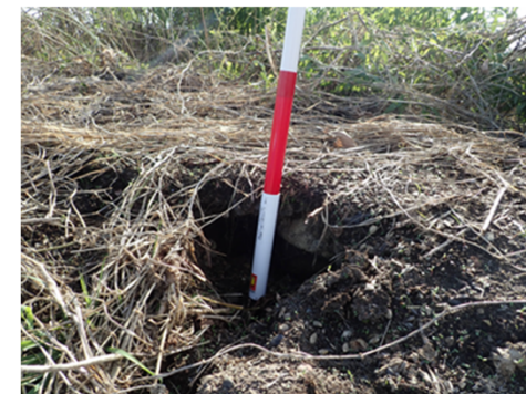
裏法肩部での侵食状況
