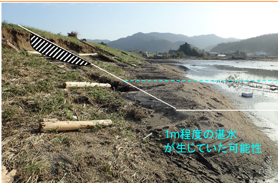
堤内地の湛水によって法尻周辺の侵食が抑制された事例 (阿武隈川水系内川左岸)
