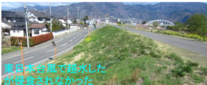
法尻部が道路舗装で被覆された状況 (信濃川水系千曲川75.6k付近左岸)
