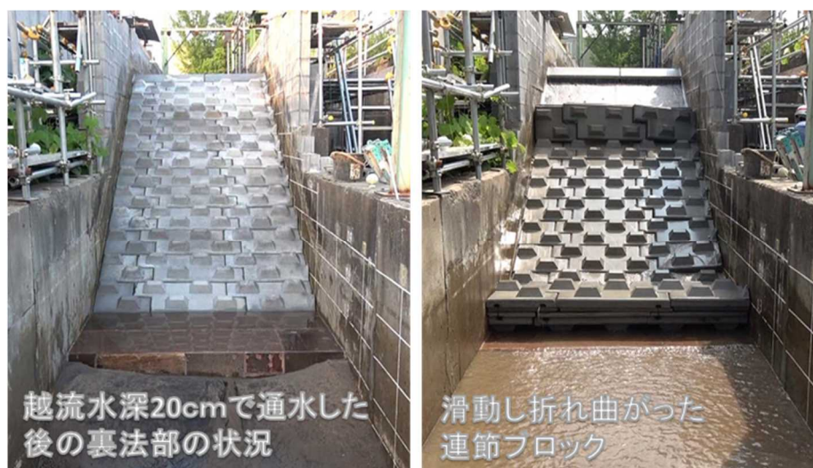
写真 5.4-2 被覆ブロックが折れ曲がった事例
