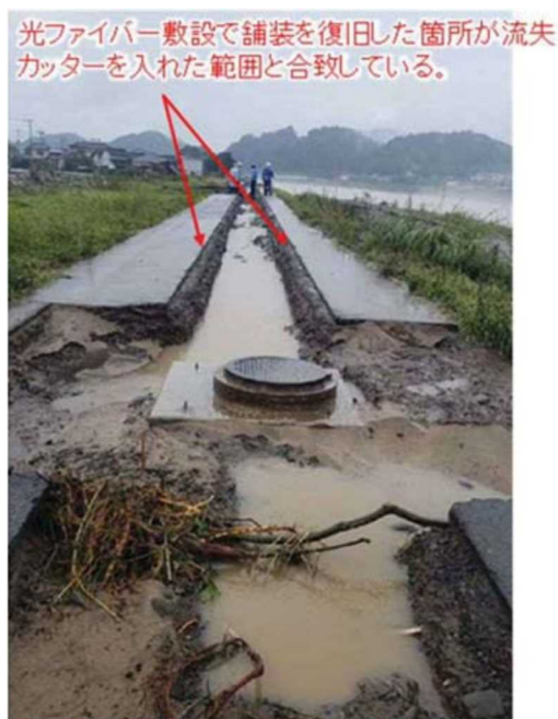
写真 2.3-6 被災箇所の舗装の流失の状況（その 1）
