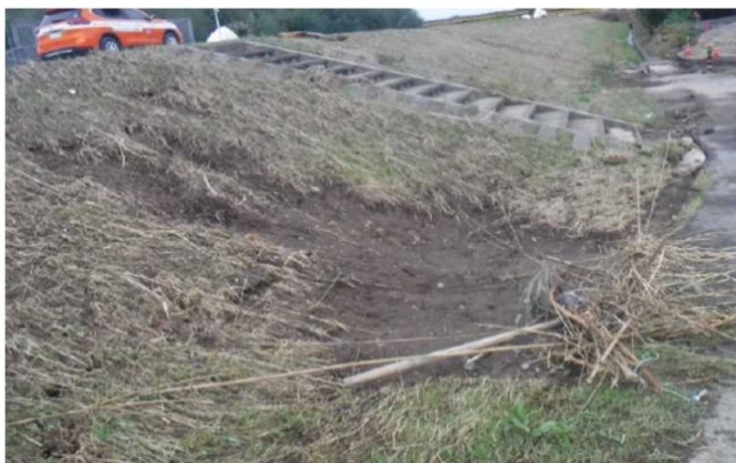
写真 2.3-2 那珂川左岸 19.5k 付近の侵食の状況
