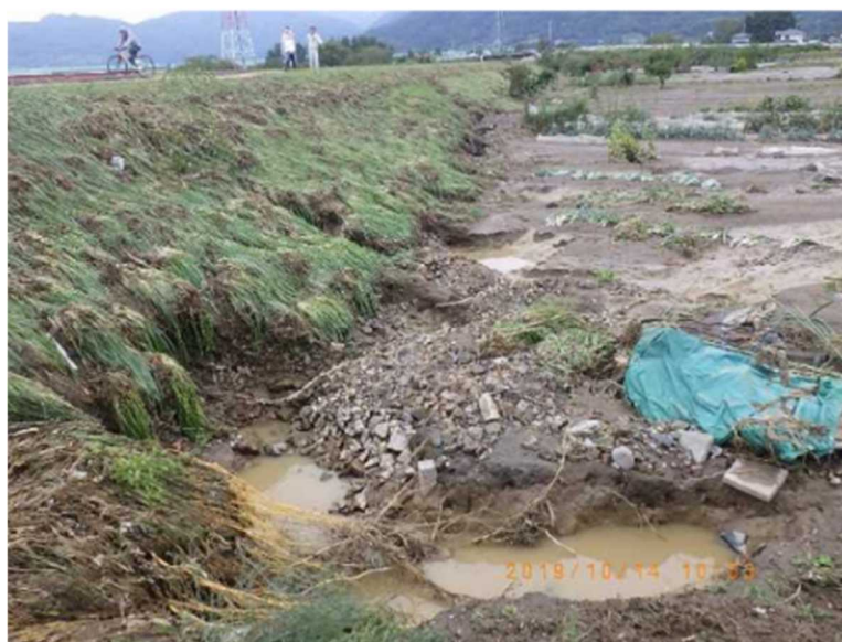
写真 2.3-3 千曲川左岸 79.0k 付近の侵食の状況
