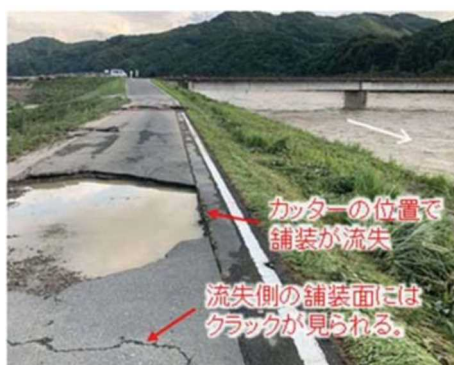
写真 2.3-7 被災箇所の舗装の流失の状況（その 2）
