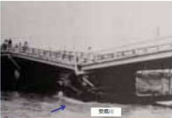
写真- 4 北摂豪雨 (S42. 7) による千歳橋破損状況 (茨木市戸伏町)
