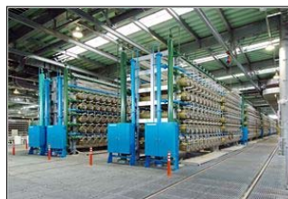
高圧RO膜設備
