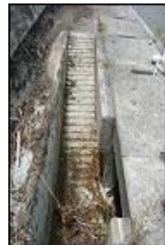
写真 3-2-2 小動物用脱出スロープ
