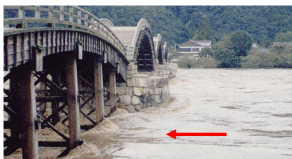
図 2.2.2 平成 11 年 9 月 24 日 台風 18 号による出水状況
