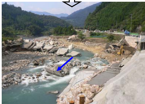
写真-⑪-3 平成 18 年出水後（全壊）
