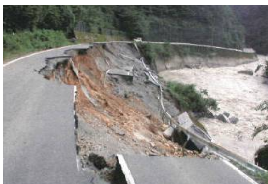
写真-⑥ 築切地区付近 国道 445 号
