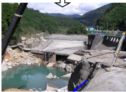
写真-⑪-2 平成 17 年出水後（一部損壊）
