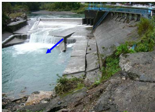
写真-⑪-1 平成 16 年出水後（一部損壊）
