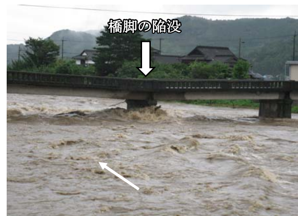
写真 2.3-2 洪水により被害を受けた橋梁
