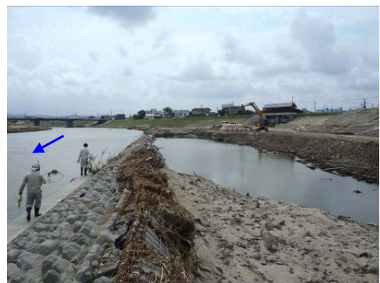
五十嵐川の高水敷の流出状況(三条市、新通川合流点)
