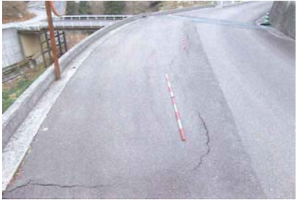
図-1.2 地すべり状況
