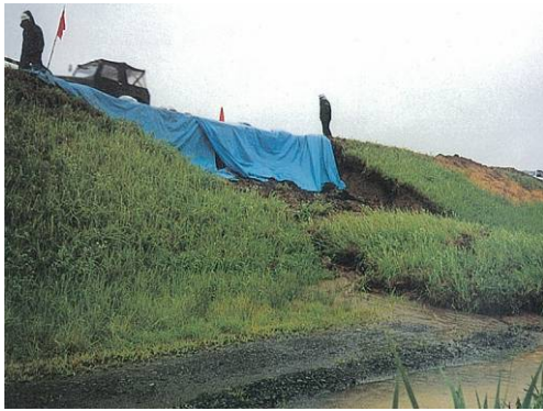
写真 2-23 堤防法崩れの状況
