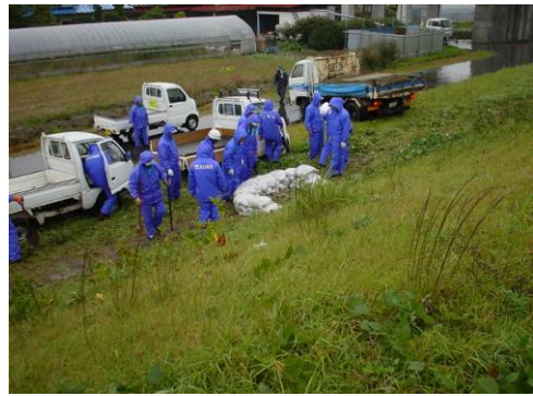
写真 2-24 漏水による水防活動の状況
