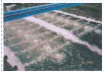
曝気装置稼働状況
