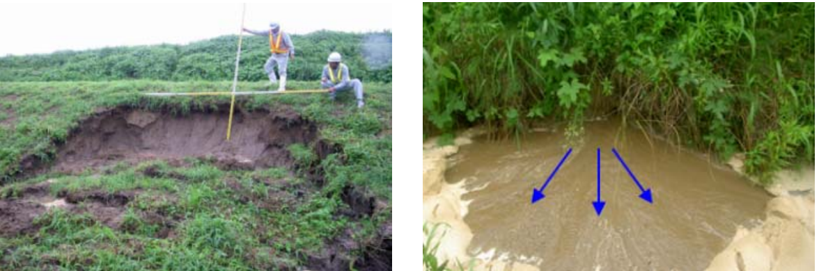
写真 1-20 平成 21 年 7 月洪水による堤防川裏法面の崩壊(L=80m)、堤防川裏法尻からの漏水
