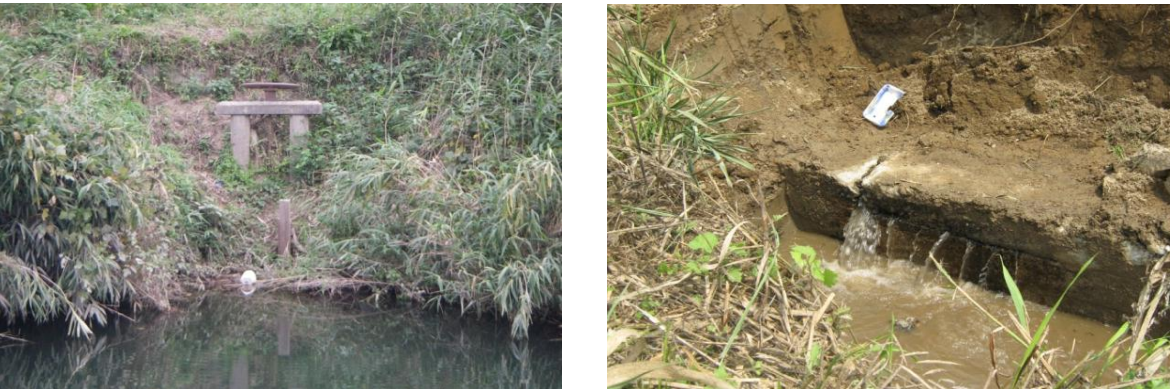
写真 1-21 樋管の状況、樋管函体からの漏水
