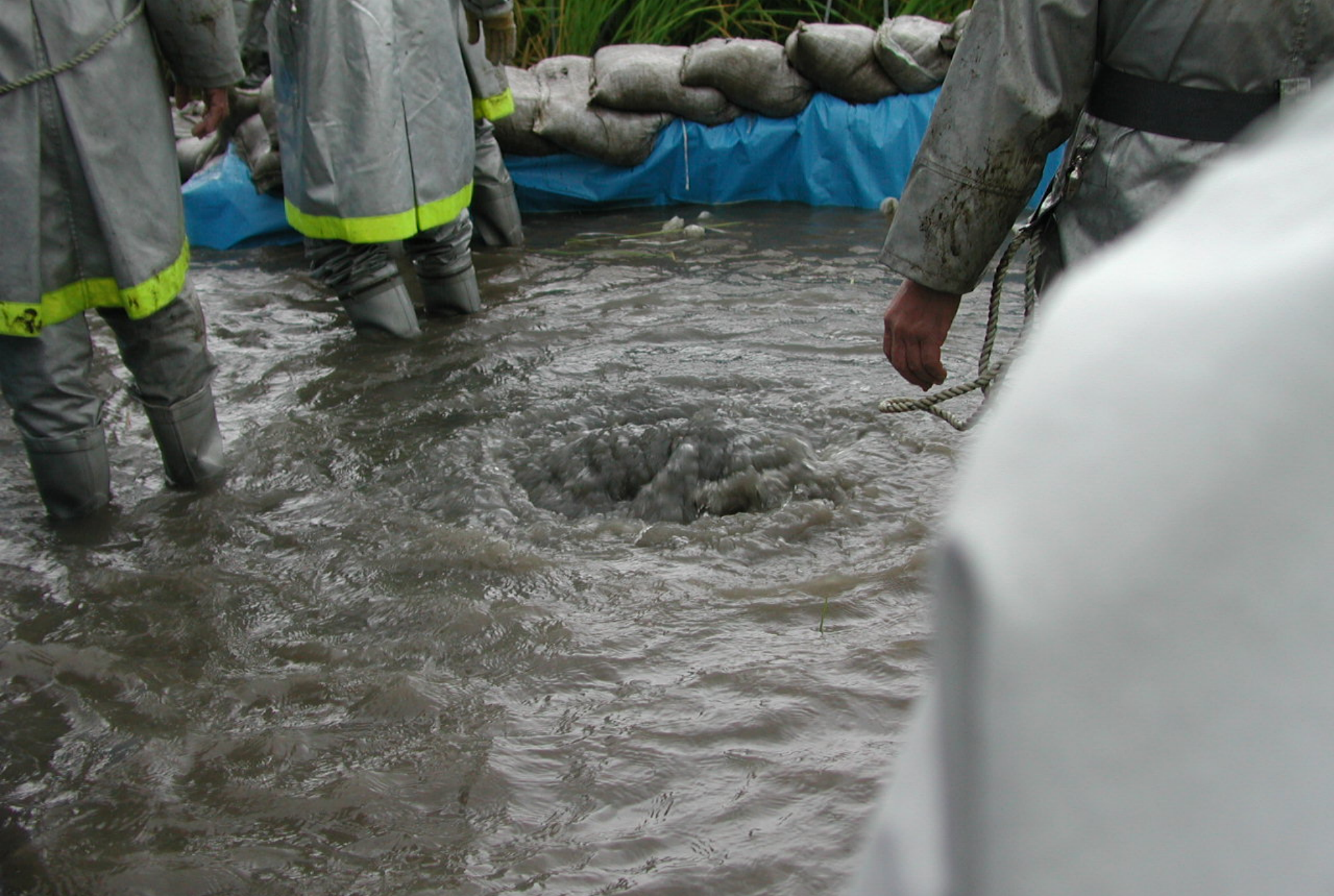
埼玉県加須市大越 釜段工内の漏水
