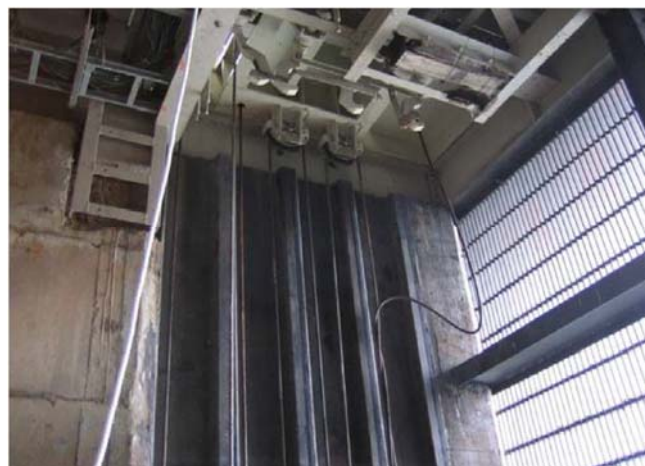
写真 3.3 比較的軽微な放流設備の損傷事例
