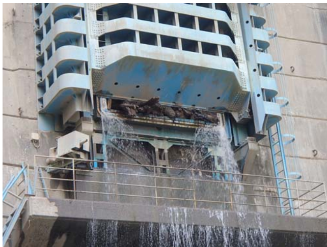
写真 3.2 平成 29 年裾花ダムにおけるコンジットゲート閉塞状況
