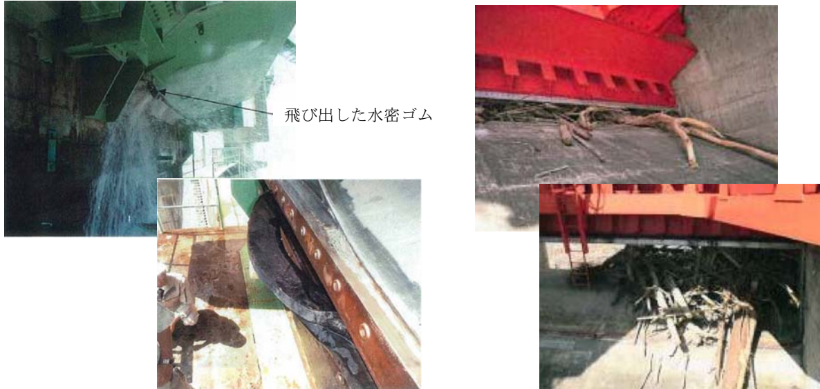
※左写真：水密ゴムの損傷
