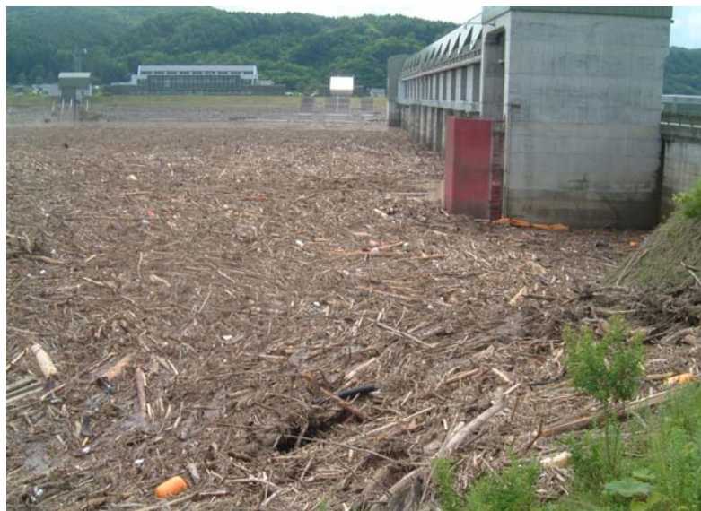
写真 1.1 平成 15 年 8 月の二風谷ダムにおける流木発生状況
