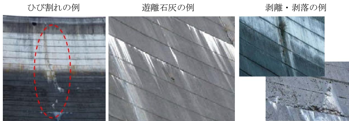
図 2.1.1 表面の損傷状況参考例（損傷例はいずれも下流面）
