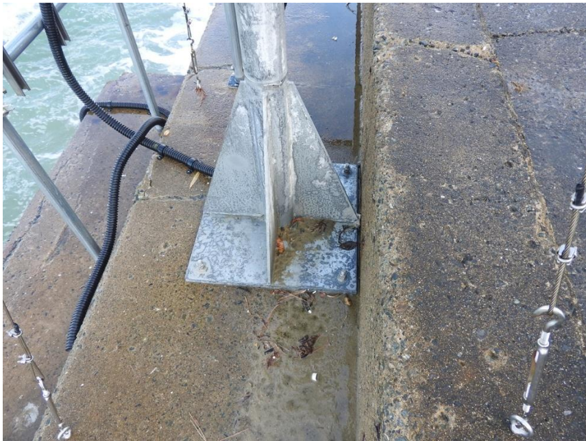
写真-巻末.2 劣化が進行した観測柱の状況
