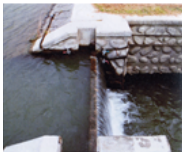
魚道上流端の角落しによる魚道流量の調節
