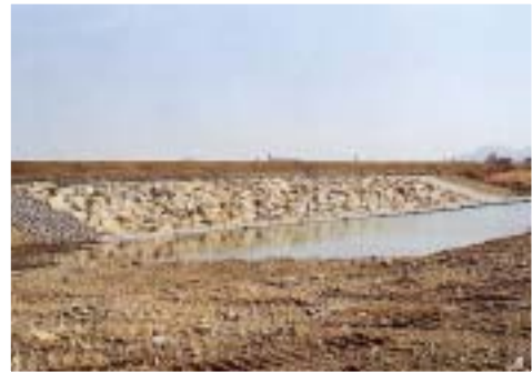
現地にない材料を用いた護岸。周辺の風景にとけ込んでいない。
