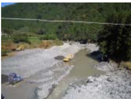
河川工事の際に発生する濁水が、下流の河川の景観に影響している。*
