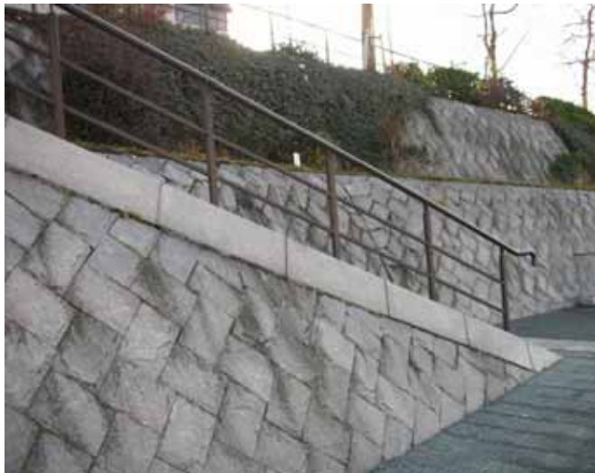
京都府・鴨川 平成 10 年頃に整備 階段との取り付け部に笠天端処理を加え、スッキリとした デザインでまとめている
