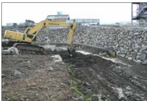
施工会社への現場指導を実施し共通認識を確保している事例
