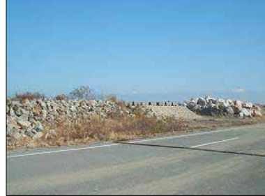
借地してヤードを確保している例 (四国地整 那賀川河川事務所)
