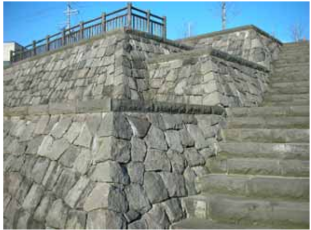
秋田県・横手川 平成 10 年頃に整備 端部や階段との取り付け部のおさまりが良い
