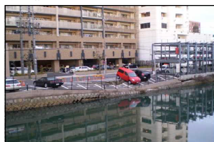
護岸の損壊状況
