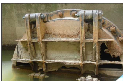
ポンプ設備(逆流防止弁)の損壊状況
