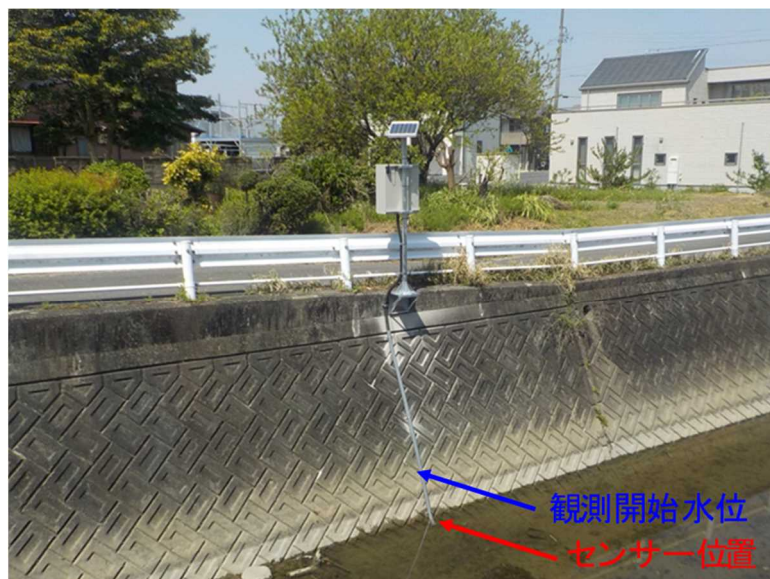
写真 3-8 護岸への水圧式水位計設置例
