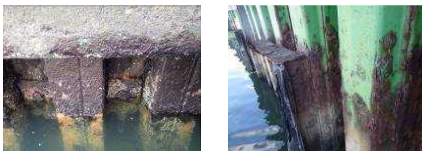
図 - 9 特殊堤防(鋼構造)の腐食(左)及び塗装の剥がれ(右)
