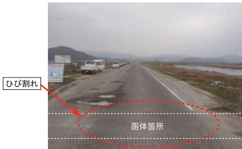
図 - 10 天端舗装のひび割れの例
