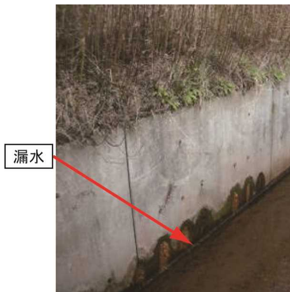
図 - 6 堤脚水路からの漏水の状況
