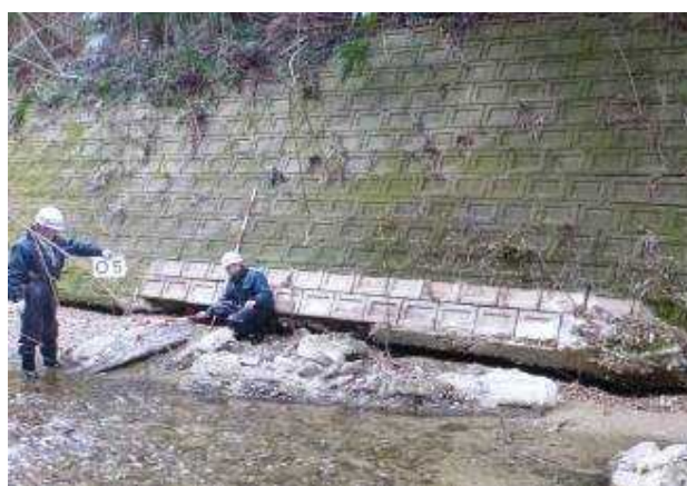
図 - 16 河床低下による基礎の露出の例
