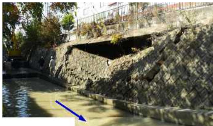
図 - 14 空洞化による被災例
