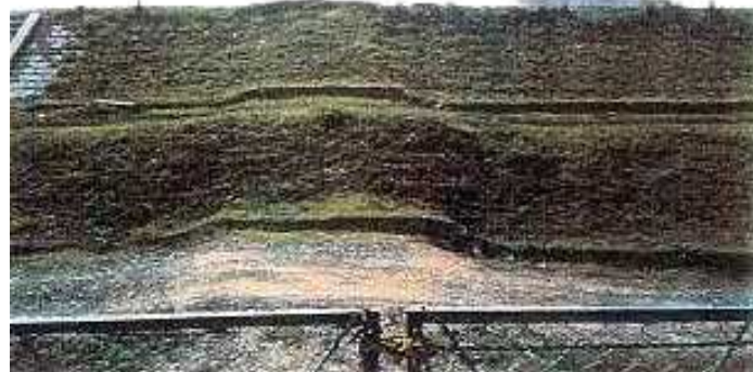
図 - 11 天端及び法面の抜け上がりの例
