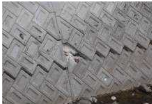
図 - 13 護岸の亀裂の例
