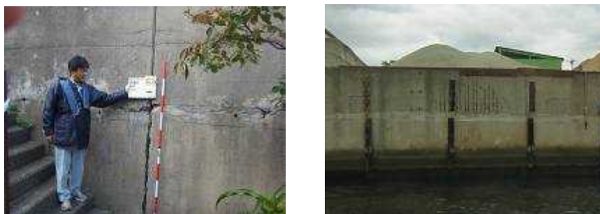
図 - 8 特殊堤(コンクリート構造)のひび割れ(左)及び剥離(右)
