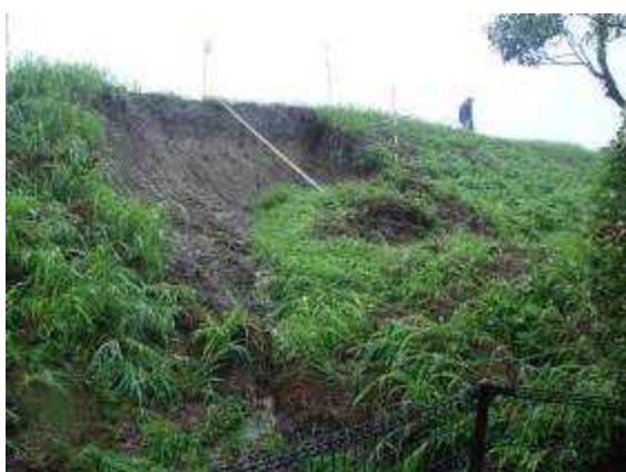
図 - 2 出水後の法崩れの状況
