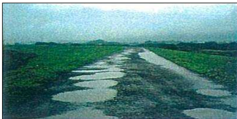
図 - 3 天端に生じた水たまりの状況
