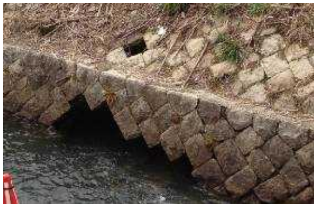
図 - 15 洗掘による基礎ブロック流出の状況
