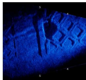
図：護岸損傷箇所 (ブロック欠損)
