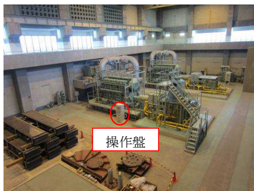
操作盤配置状況
