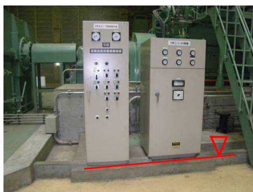
操作盤配置状況
