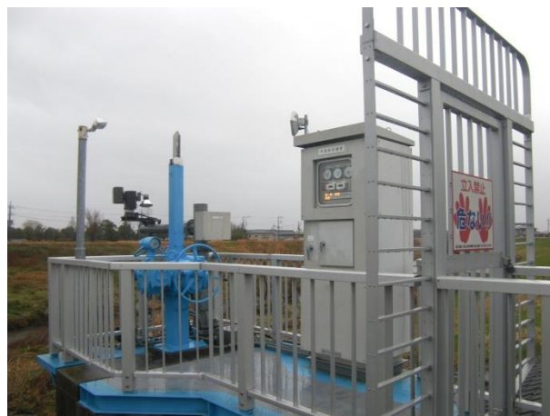
操作・分電盤等の例
