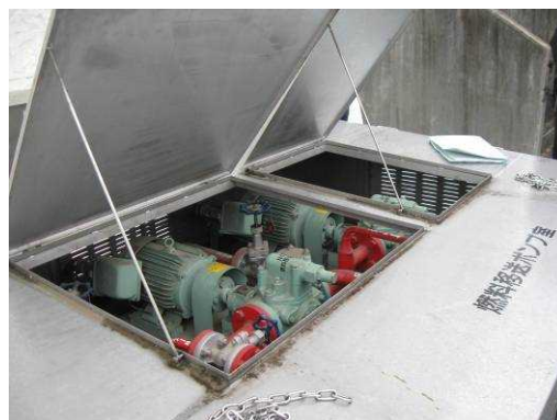
燃料移送ポンプ設置状況
