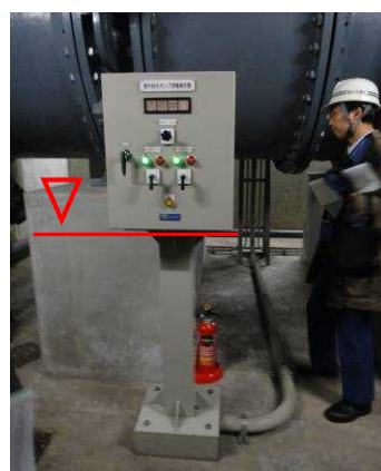
操作盤配置状況
