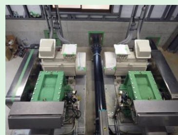
水車発電機 2基
