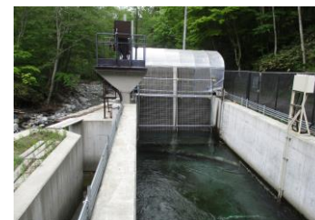
図7.8 沈砂池・除塵機・排砂口
