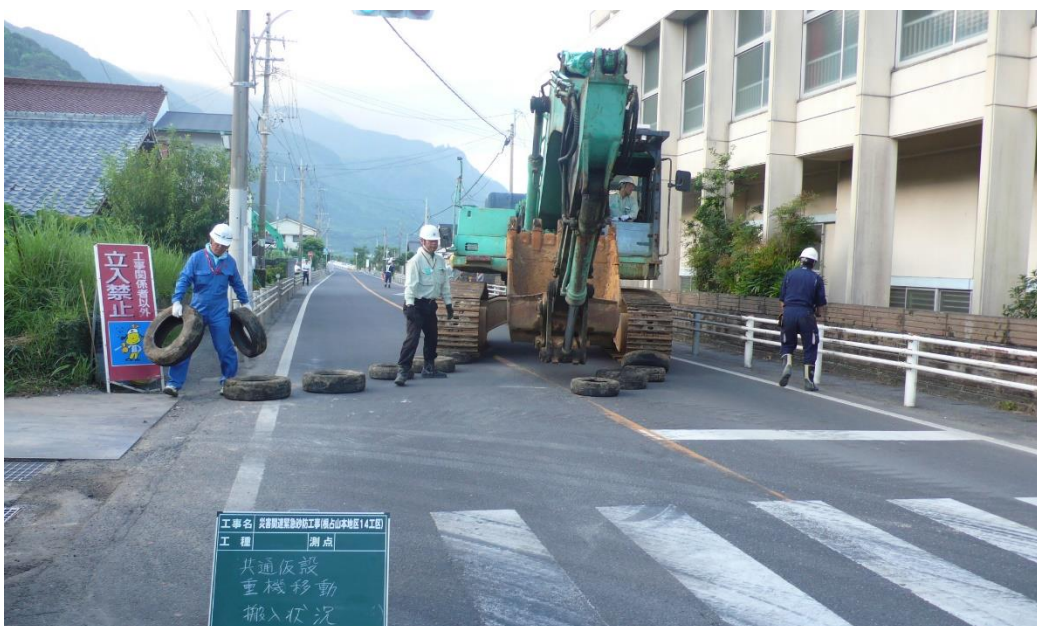
写真-4.5 重機組立後、自走した事例
