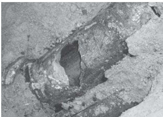
破損した取付管(Zパイプ)
