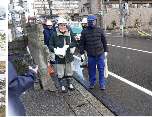
緊急調査状況 (新潟亀田内野線・西区青山1丁目)
