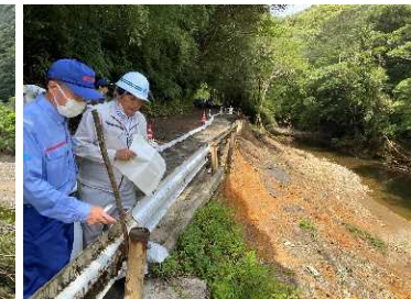
緊急調査状況(市道役勝三川線)
