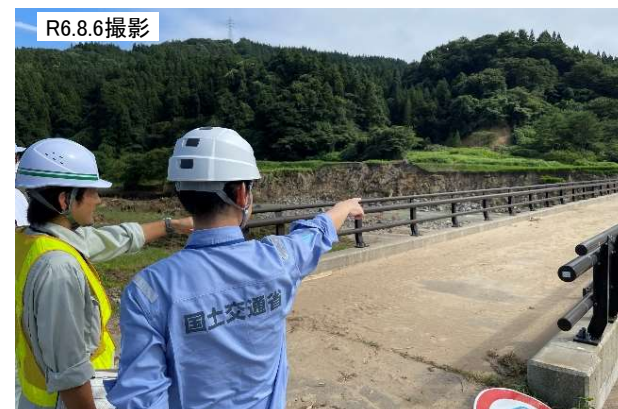
緊急調査状況(市道前山線 前山橋) 【助言】 ・橋台背面が侵食されている状態となっているため、橋台を中心に変状、変形を計測するとともに、点検をし、健全性を確認すること。
