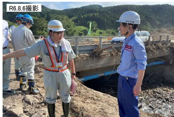
緊急調査状況(国道344号 石田橋) 【助言】 ・橋梁に添架されている水道管の被災も確認すること。 ・次期出水時に被害が発生しないよう、河川の埋塞土砂の撤去を検討すること。
