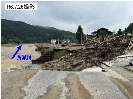
国道344号(酒田市) 被災状況
