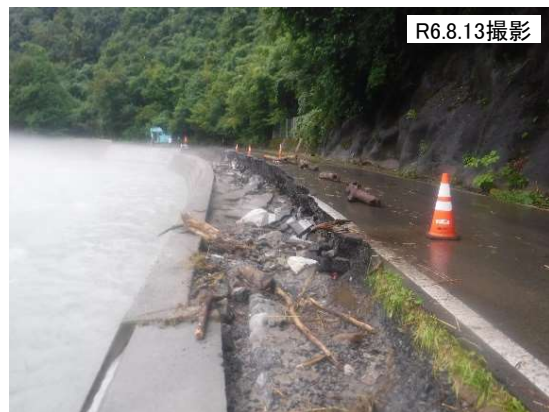
いっばんけんどう ふだいこやせ せん 一般県道普代小屋瀬線(岩泉町) 被災状況
