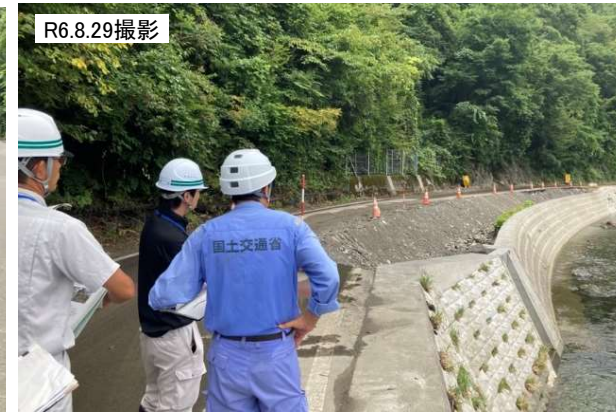
緊急調査状況(普代小屋瀬線 川口) 【助言】 ・護岸の健全性により、改良済み区間の護岸高に合わせる原形復旧や被災原因除去のための張コンクリートによる復旧など、様々なパターンが考えられるため、詳細に確認のうえ、復旧方針を検討すること。
