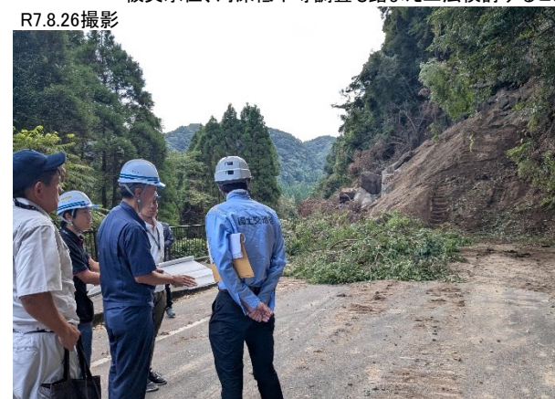
緊急調査状況(犬飼霧島神宮停車場線) 【助言】 ・斜面に不安定化した岩塊が多数残存しており、工法検討に時間を要すると考えられるので、斜面の応急対策を含めた仮設工も検討すること。
