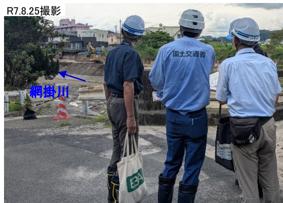
緊急調査状況(二級河川 網掛川(龍門滝)) 【助言】 ・橋梁上流側の欠損箇所の応急工事を実施すること。 ・被災水位、被災メカニズムを調査し、工法を検討すること。
