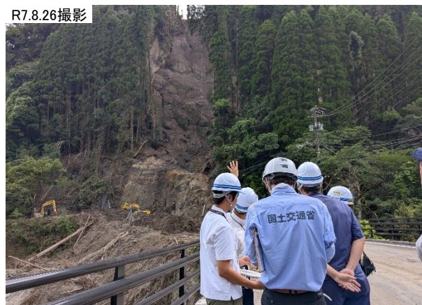
緊急調査状況(国道223号) 【助言】 ・斜面状況調査(転石、亀裂、緩み等)結果と被災のメカニズムを踏まえて、被災原因の除去が図れる復旧工法を検討すること。
