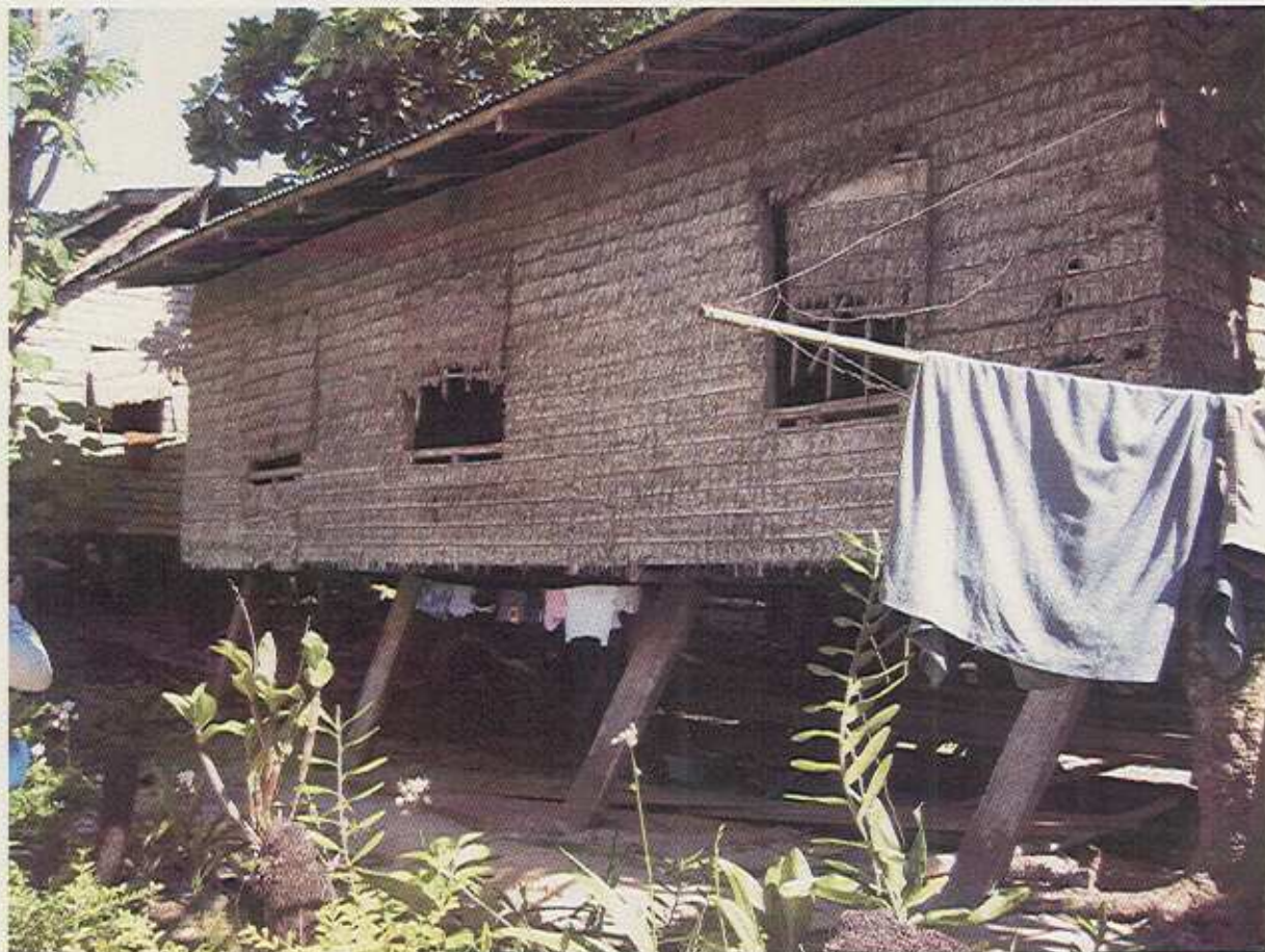
②地震によって基礎部分が傾いた高床式の住居 ガテレ村(コロンバンガラ島)
