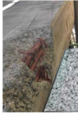
損傷状況 (鉄筋露出)
