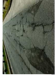
<劣化状況（国道）>
