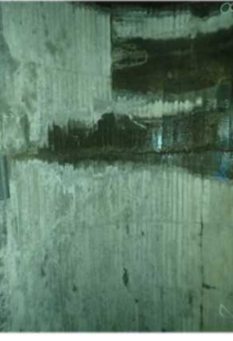
損傷状況 (うき・漏水)
