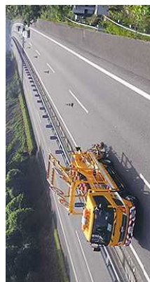
<規制機材の自動設置状況>
