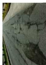
＜劣化状況（国道）＞
