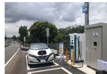
< EV充電器の公道設置（横浜市） >
