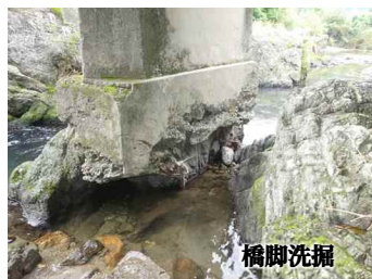
判定区分IV（緊急に措置を講ずべき状態）
