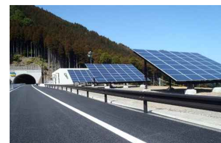
<道路における太陽光発電の活用>
