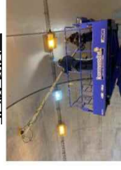
レーダーを利用したトンネル覆工の損傷把握
